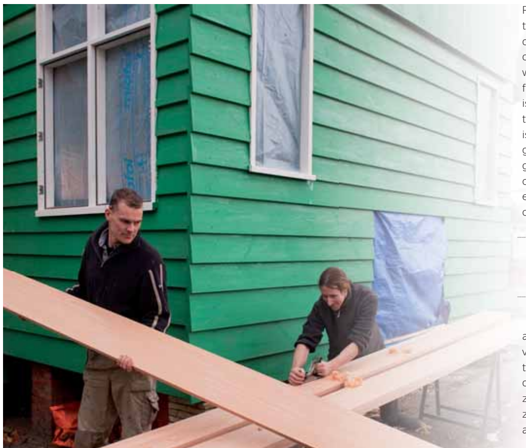
Leermeester Paul Aafjes (links) restaureert met zijn leerling Thijs Doornbos een authentiek Zaans huisje. De woning dateert uit 1850. "We proberen te motiveren, maar zijn ook streng."
